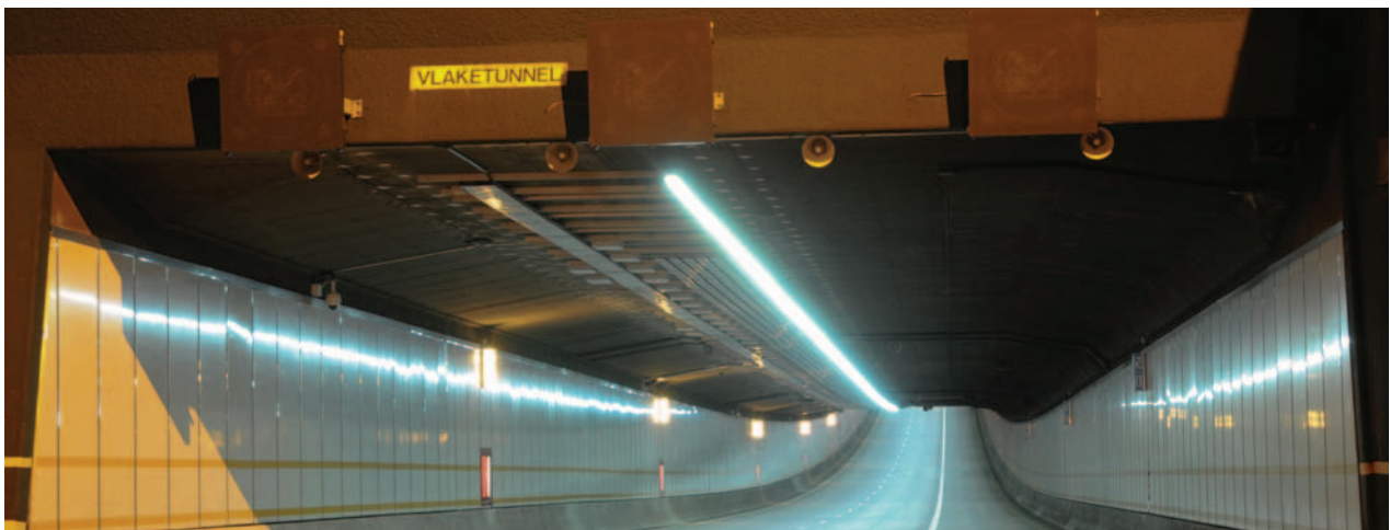
Túnel de Vlakte, situado en la provincia de Zuid-Beveland, Zeeland, Holanda. Instalación de la luminaria con tecnología LED model T-line, de Indal.
